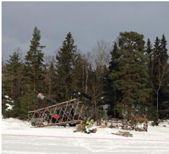
Sista ledningsstolpen har fallit.
